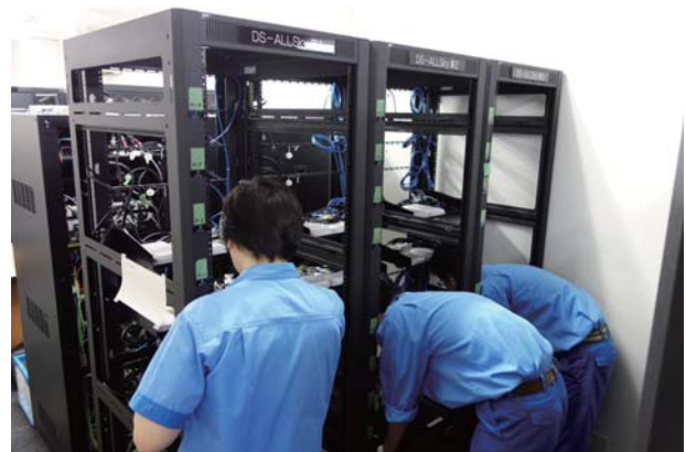
PC 類が取り外された、調整室ラック
