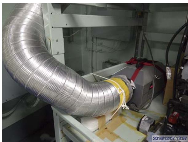
写真5 第四観測室に設置されたサンプラー
